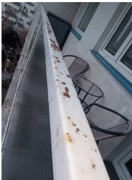
OBR: 13 – Horizontální deformace madla zábradlí
