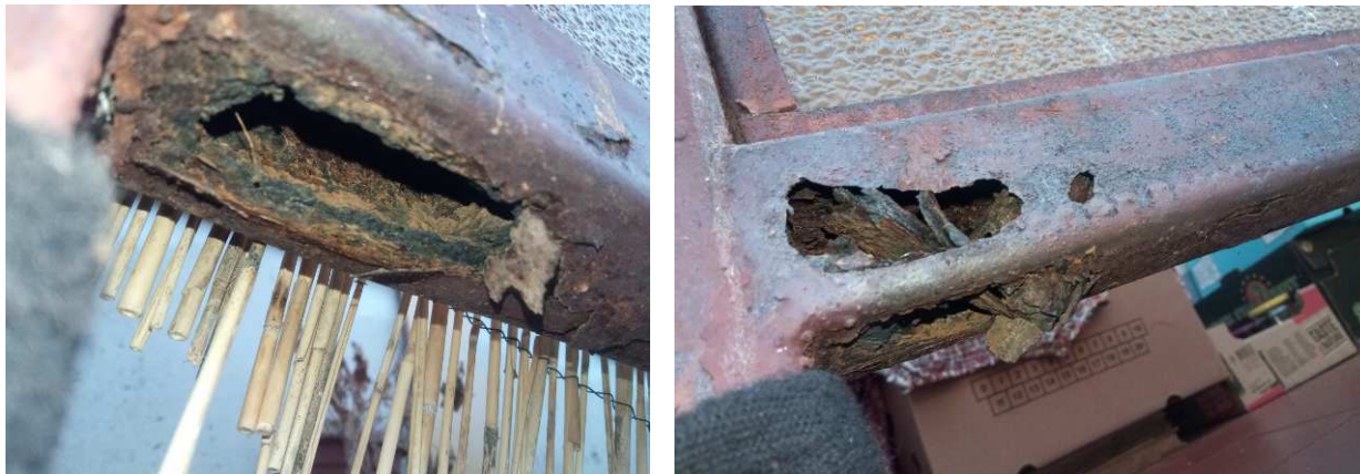
OBR: 10, 11 – 100% korozní poškození profilů zábradlí
