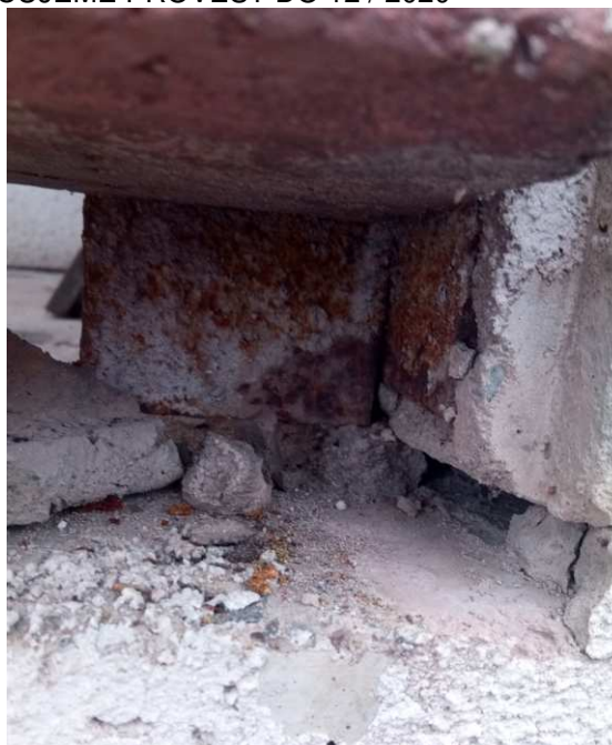
OBR: 06 – Poškozený panel s odhaleným kotvením
